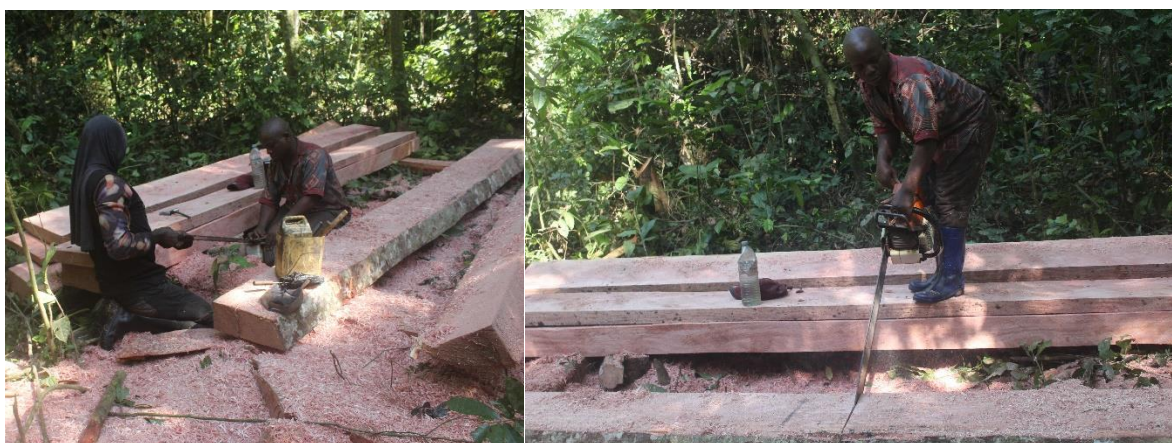
Figure 11: Travailleurs sans équipement de protection individuelle, Coordonnées S : 2,901775'' E : 27,983494''
